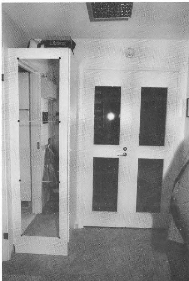
Standardhall/kapprum i lägenhetstyp A1 med dörren till vardagsrummet stängd. T.v. dörren till köket, här avhakad. (nr 1)
