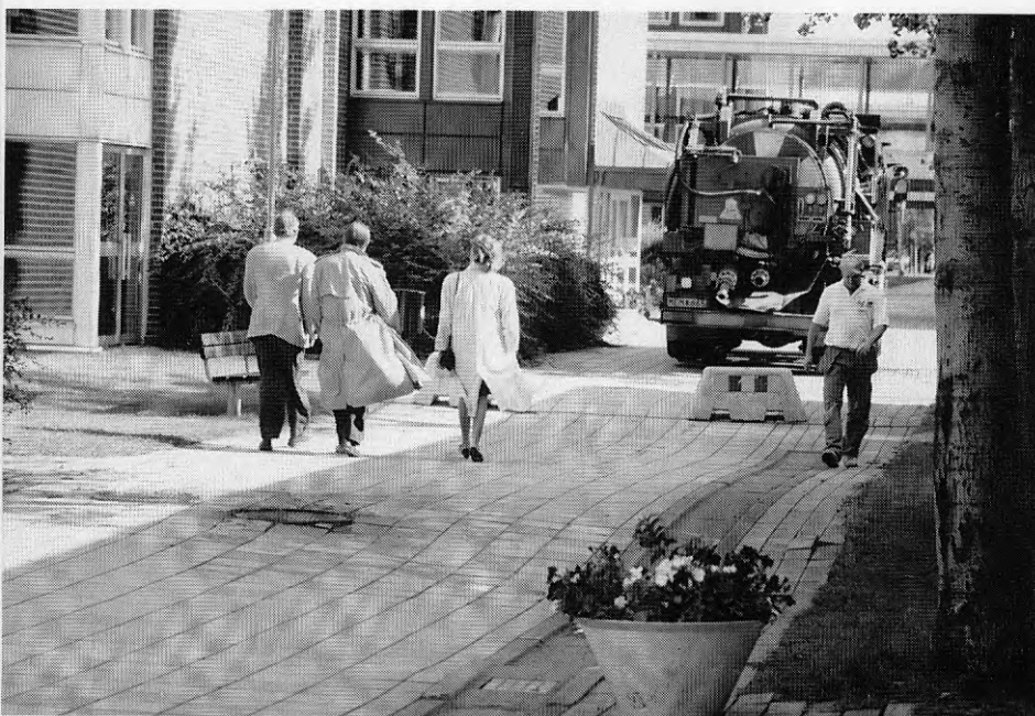
Bild 75 Sättningskadorna i centralstråket i Norrköping.
