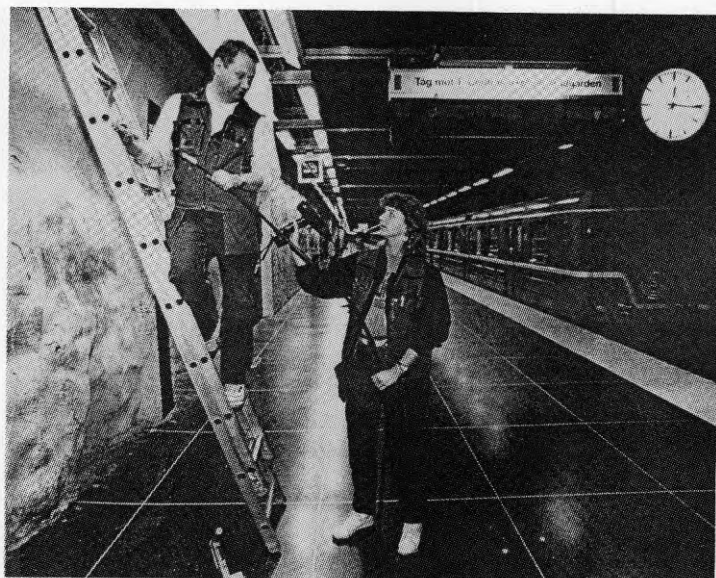
Figur 7.4:2 – Securitas fick uppdraget att installera ny kommunikationsutrustning för ökad säkerhet i Stockholms tunnelbana.
