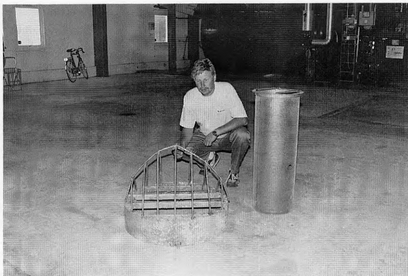
Fig 4.2 Åvattenintagets skyddsgaller, samt filterkorg till Alfa-Strain filtret.
