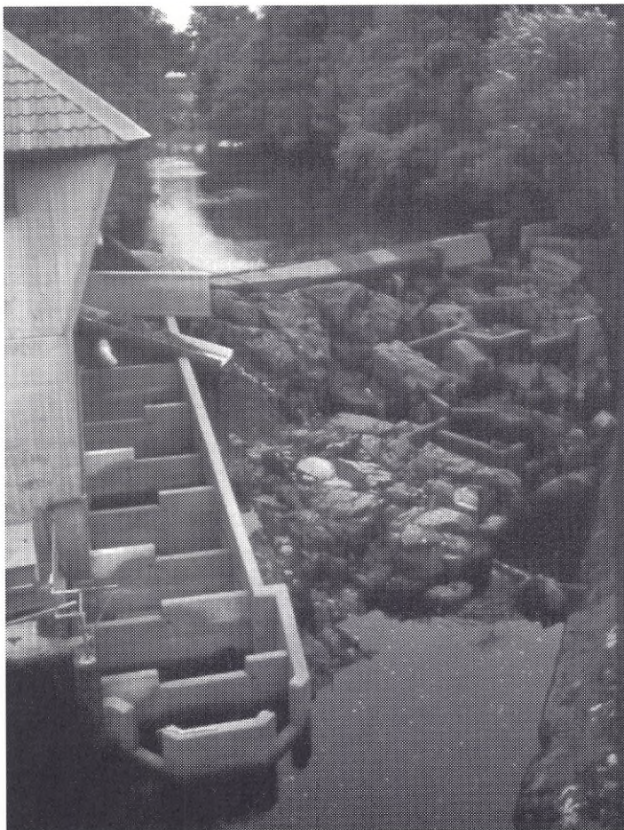
Bobergs kraftverk och fisktrappa i Suseån.
