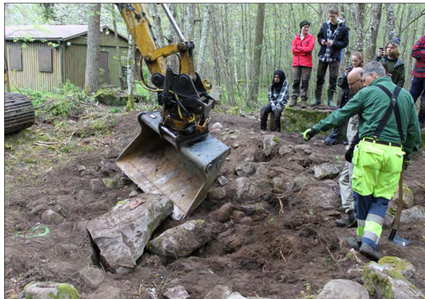
Nedan: Spänd förväntan på vad som döljs under de större stenarna, som avlägsnades med grävmaskin. Foto: Maria Persson
