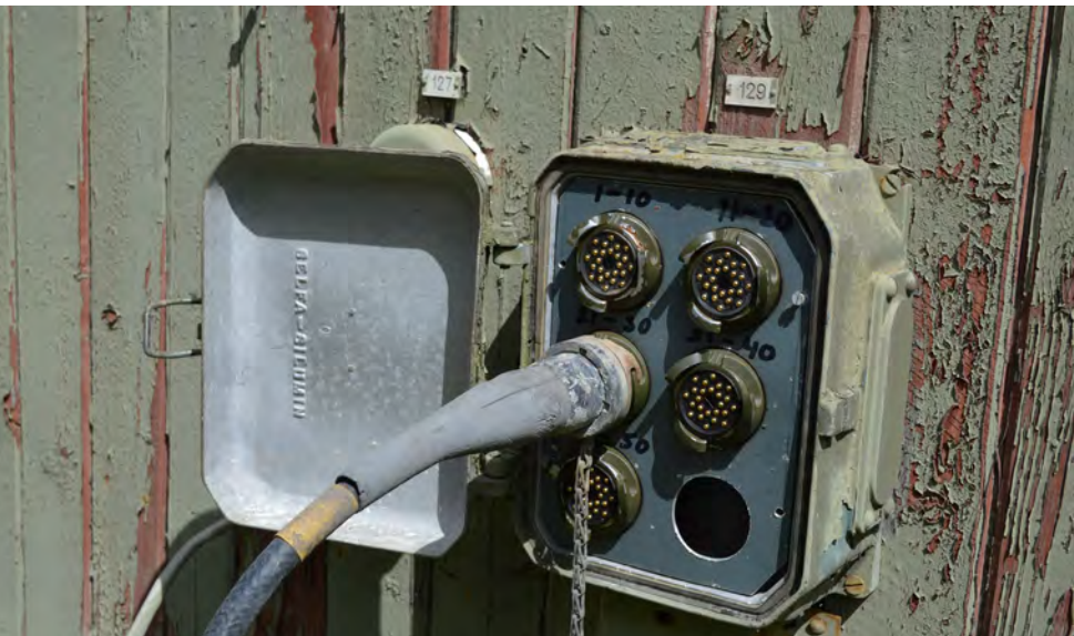
T.v: Telekabel (10 DL) inkopplad i anslutningsplint på byggnad 1. Kabeln och anslutningsplinten användes för att ansluta olika mobila enheter, exempelvis signalstationsvagn. Foto: Hans Grimhammar
