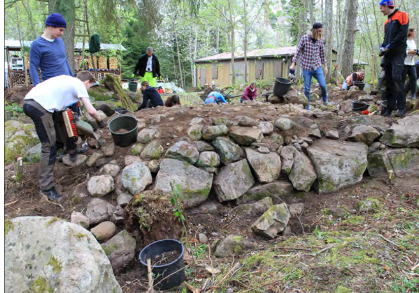
Ovan: Studenterna rensar fram stenpackning väster om byggnad 4. Arbetet utfördes med skärsliv, skyffel och borste. Foto: Tony Axelsson
