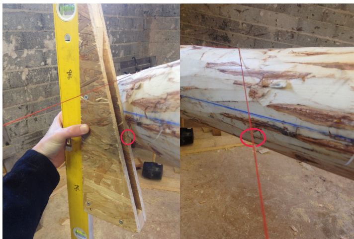
Figur 29 & 30 Med hjälp av vinkelmallen kan underkant av sticksparren korrekt märkas ut och sedan urtaget genom att följa murarsnöret Foton: Torbjörn Einarsson
