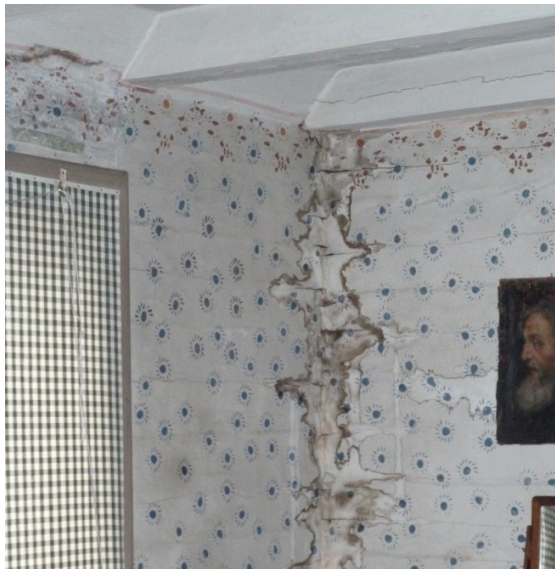
Fig. 3. Exempel på fuktskadad tapet. Skansen.
