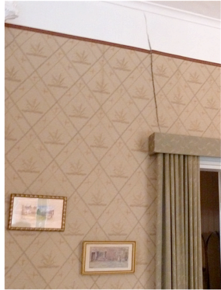
Fig. 4. Exempel på reva i tapeten på grund av rörelser i byggnaden. Skansen.
