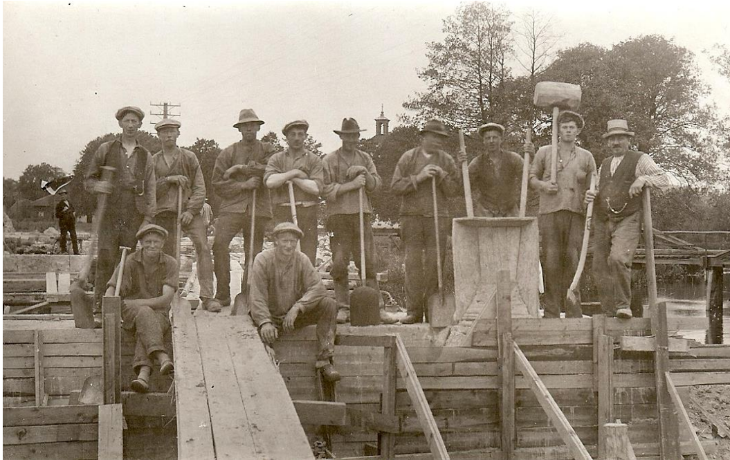
Fig. 27. Timavlönade brobyggare vid uppförandet av Nya Nolby stock, 1923. Som stadsingenjör var Bengtson ansvarig för såväl de anställda arbetarna vid stadens tekniska anläggningar, däribland gasverket, som de timavlönade arbetarna som utförde stadens allmänna arbeten. Arbete som utgjordes av allt från framdragandet av vägar till nedläggning av vatten- och avloppsledning till byggandet av broar.
