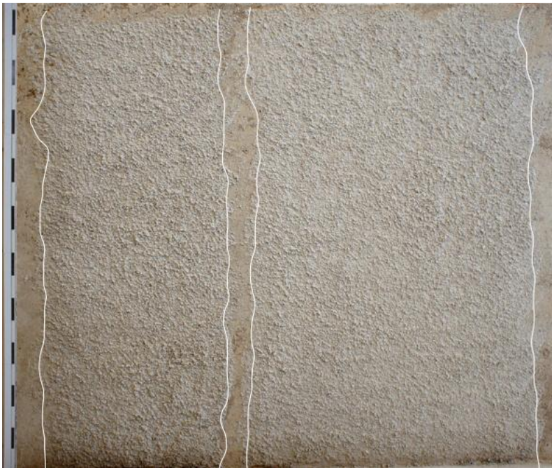
Fig. 24. Blandning 9 och 9a. Vänster putsyta är slagen emot föregående påslag och höger putsyta är slagen ifrån föregående påslag. Den vänstra ytan är påtagligt mindre trots att samma mängd bruk använts till båda ytor.
