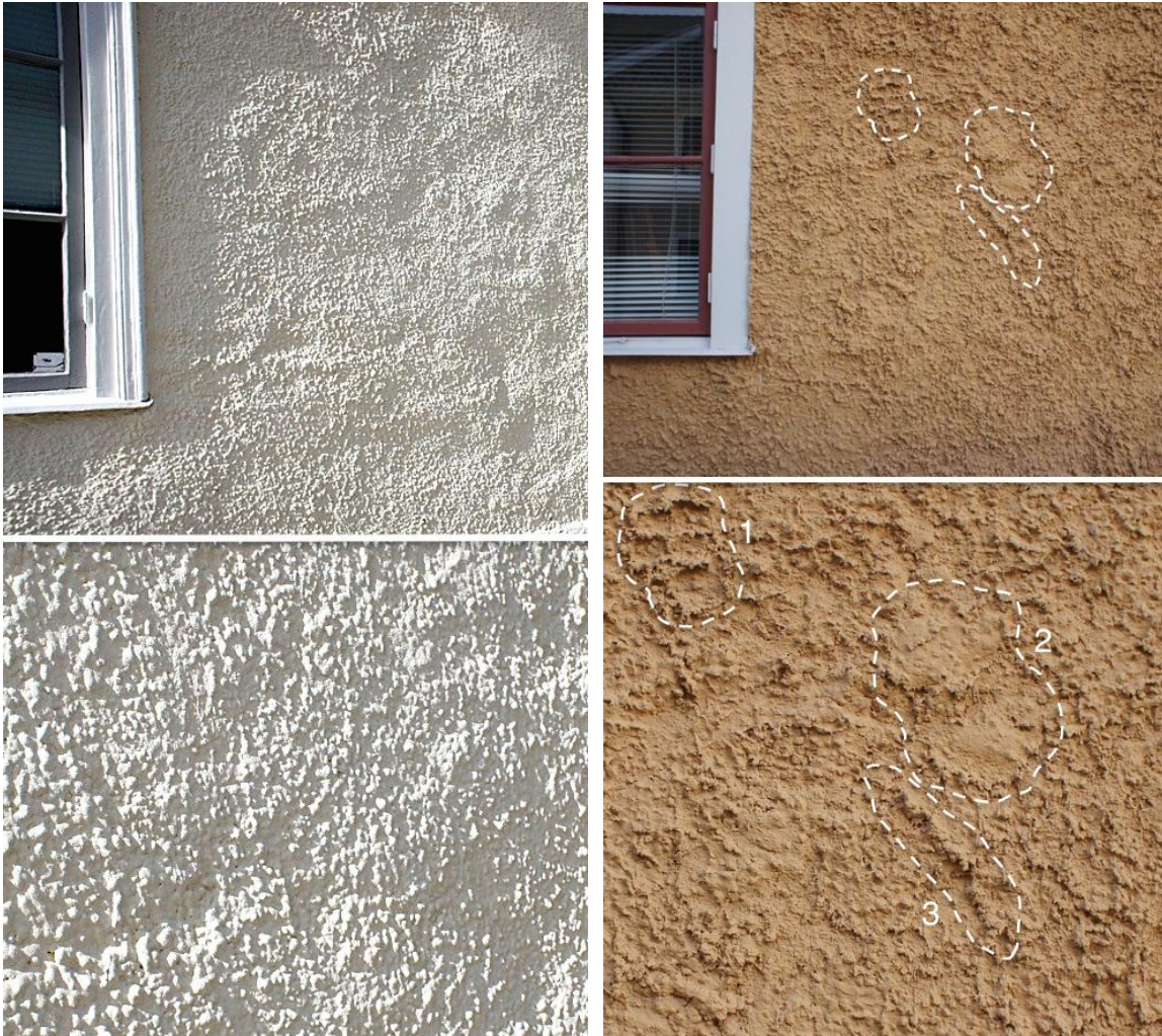
Fig. 3 Nedre bilder är närbilder av de övre bilderna. Den högra putsen har en okontrollerad struktur med olika oönskade former. Markeringar i bilden nere till höger visar exempel på detta. 1. Brukspåslag som bildat gropar i putsen. 2. Två lite större brukspåslag intill varandra som är slätare än övrig puts. 3. Påslag som bildar en tydligt framträdande rygg. Fasaden till vänster har en yta som buktar in och ut. Detta beror troligtvis på underlaget, spritputsen i sig själv har en homogen struktur.
