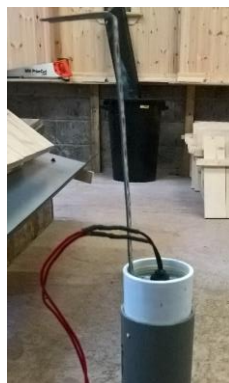
Figur 74 Skarvmuff med nivåströmbrytare instucken i 50 mm röret på uppsamlingskärlet.
