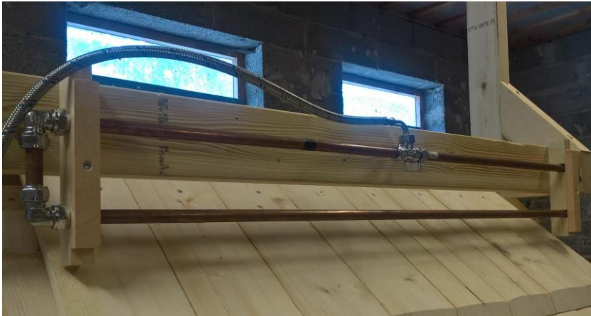
Figur 66 Spridningsrampen av 15 mm kopparrör. Rampen monterades senare på en regel tvärs över provytan.
