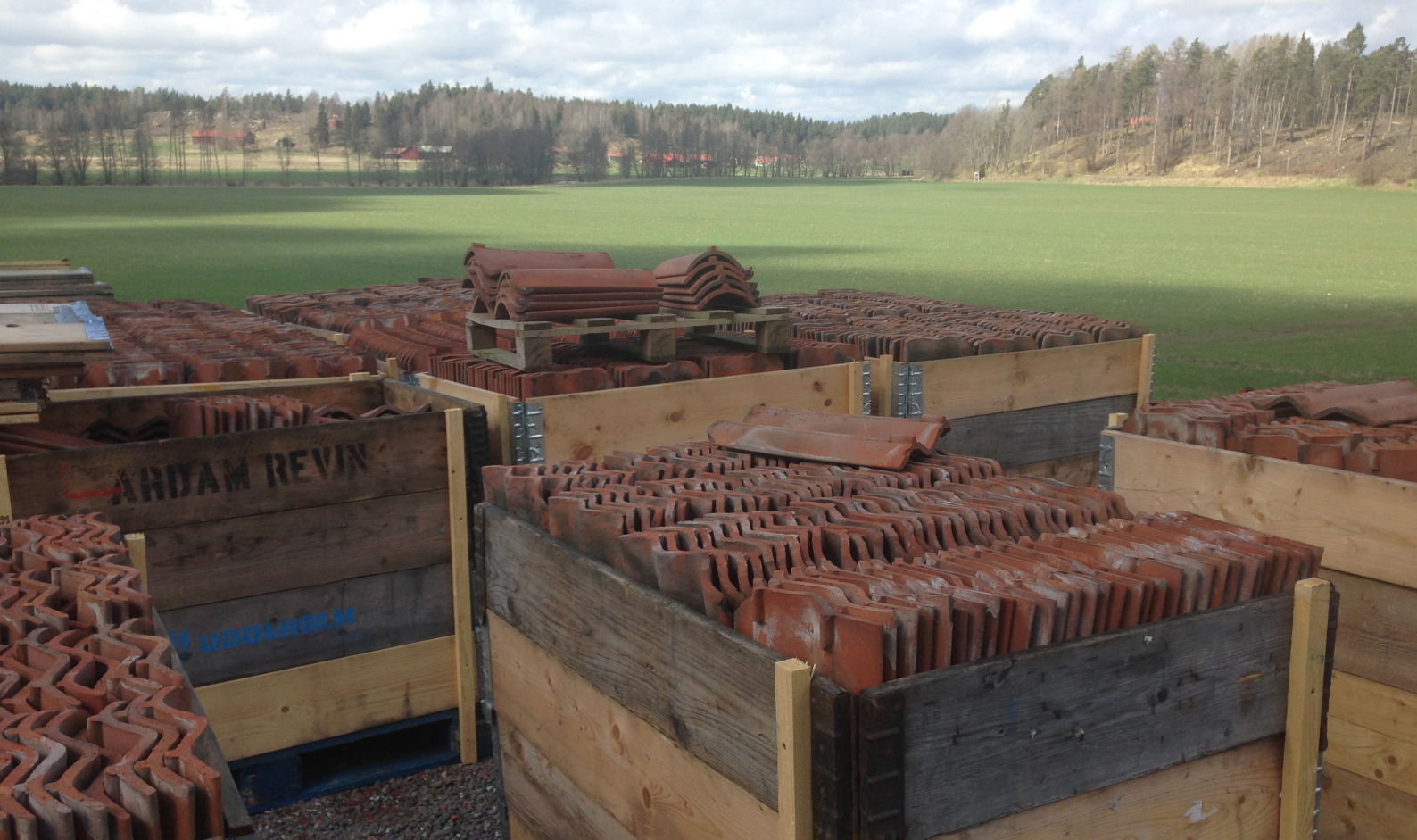
Figur 4.1. Taktegel ska inte förvaras direkt mot mark då det lätt suger upp markfukt. Ett förvaringsätt är att ställa dem på högkant i pallkragar på lastpallar.
