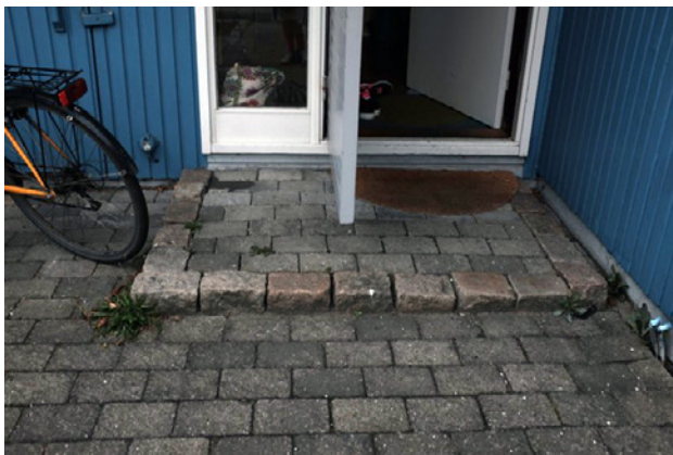
Figur 11. Stenläggning vid entré.
