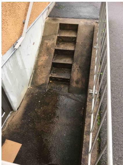
Bild 8. Smala och branta stentrappor till källarförråd försvårar tillgängligheten. I mitten finns smala trappsteg och på sidorna en stark lutning som används exempelvis för att leda en cykel.
