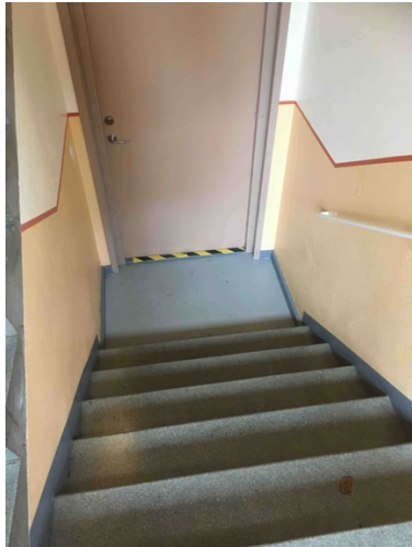
Bild 21. En stentrappa där kontrastmärkningen monterats vid dörrtröskeln. Stentrappan saknar kontrastmärkning vid samtliga steg.
