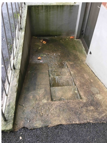
Bild 9. Smala stentrappor till källarförråd kan vara hala vintertid. Smala trappsteg och relativt långt avstånd till räcke.
