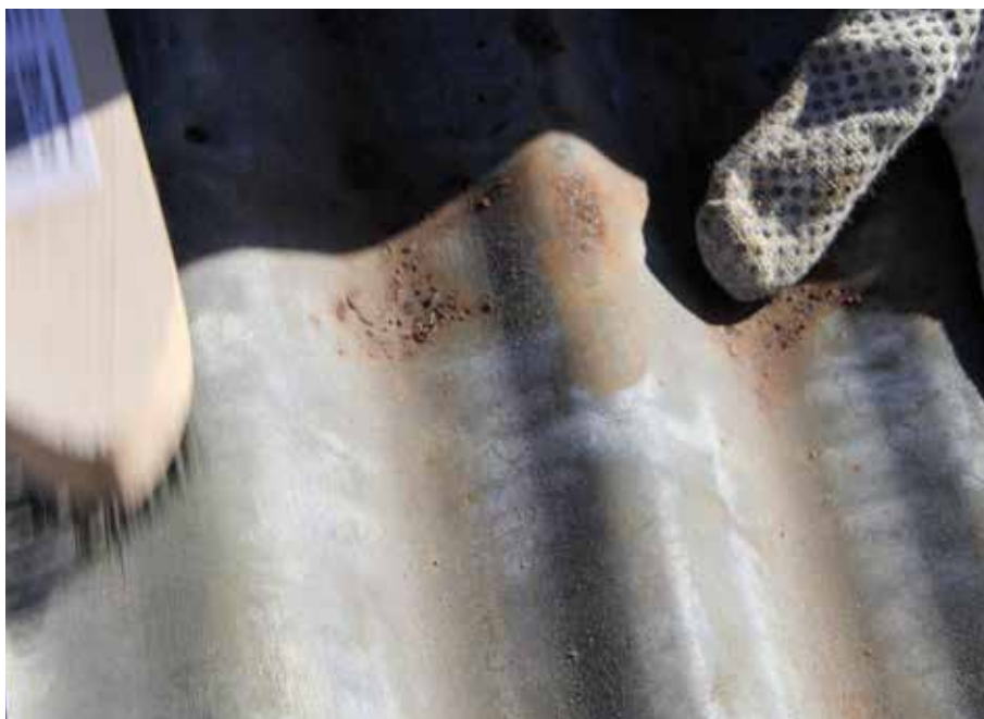
Figur 3.40. Det är svårt att få bort rostfläckar med enbart stålborstning som rengöringsmetod.
