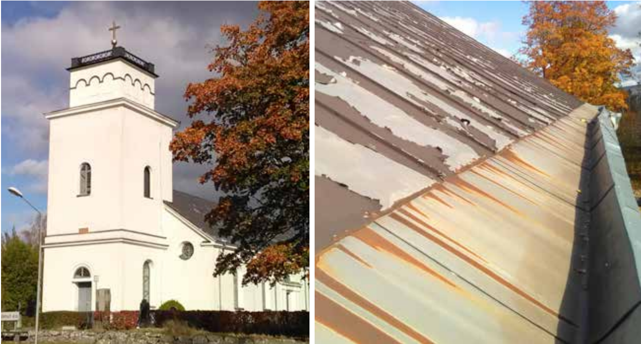
Figur 3.18. och 3.19. Avrinning av zink i fotplåtar är vanligt p.g.a. höga vattenhastigheter. Det resulterar med tiden i korrosion av stålet. Man kan även se inverkan av rostangrepp som uppstått efter att zinksikten skadats "mikroskopiskt" vid falsning. Edshults kyrka i Eksjö kommun. Foto: Tomas Ljungdahl.
