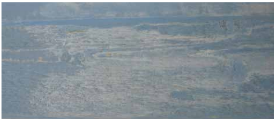
Figur 3.31. Förtvålning av linoljefärg (på trä) som tvättats med alkaliska tvättmedel utan tillräcklig eftersköljning.
