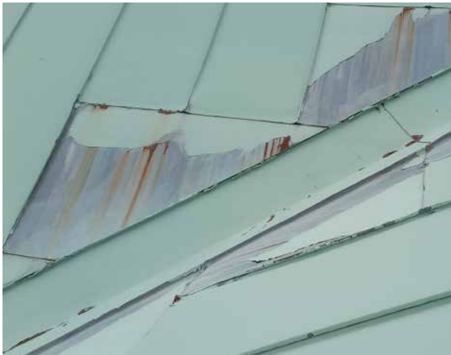
Figur 3.24. Exempel på flagande plastisol med lokala rostangrepp.
