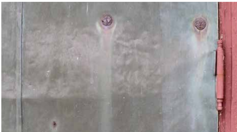
Figur 3.14. Stålnitar som rostar i kontakt med kopparplåt. Korrosionshastigheten riskerar att bli hög. Visar förhållandet liten anod – stor katodyta, med metallisk kontakt.
