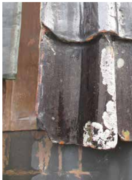
Figur 4.2. Kopparplåt i direktkontakt med zinkplåt. Kopparjoner har fällt ut på zinken och kommer sannolikt att leda till galvanisk korrosion av zinkplåten. Skoklosters slott mars 2016.
