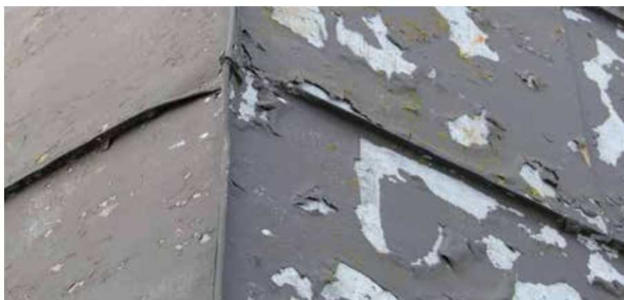
Figur 4.5. Befintliga färgskikt på ett varmvalsat, varmförzinkat plåttak som målades för 18 år sedan (1999) med omfattande flagning på sydsidan och flagning och krackelering på norrsidan.
