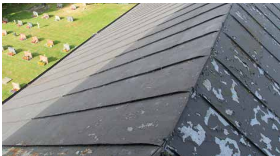
Figur 5.9. Färgskikt på kyrktakets norra (till vänster) och södra sida. Att man kan se en så tydlig skillnad på skador indikerar att även solljus (och möjligen även våttider) inverkar på skadeförloppet. Exponering av strålning, fuktigheter och värmepåverkan är viktiga faktorer som påverkar risk för foto-kemisk nedbrytning. Södra Solberga kyrka i Växjö stift.
