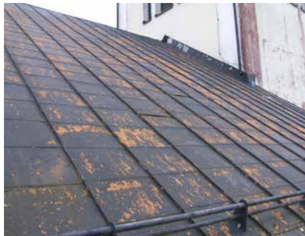
Före åtgärder. Foto: Sörmlands museum.
