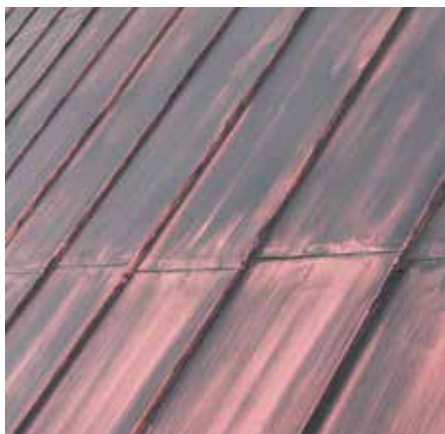
Figur 4.3. Eroderande linstandoljafärg på en grundfärg av plattmålad epoxiester efter 13 år.
