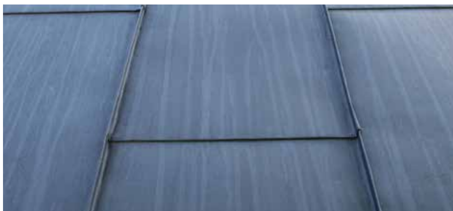
Figur 3.41. Algtvättmedel som fått verka i en månad underlättade tvätt av plåttak på norrsidan, Askeryds kyrka i Aneby kommun, Småland, 2017.
