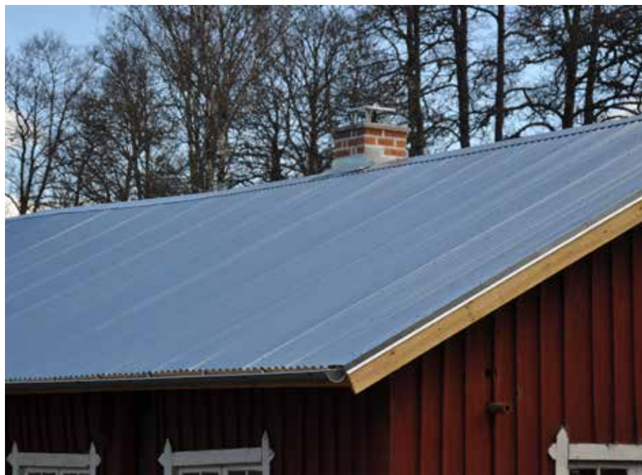
Figur 5.3. Ny omålad korrugerad varmförzinkad plåt (Z350), Kvarnabergets Vagnhjulverkstad i Vaggeryd, 2017.
