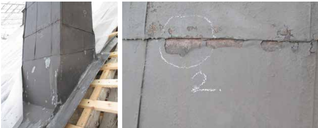
Figur 4.15. och 4.16. Foto från Skoklosters slott i mars 2016 som visar hur färgprov kan markeras. Platsen där färgprov 2 togs är markerad med tavelkrita, på en plåtklädd ålderdomlig skorsten på västra sidan vid takfot. Beklädnad mot tak är i modern zinkplåt.
