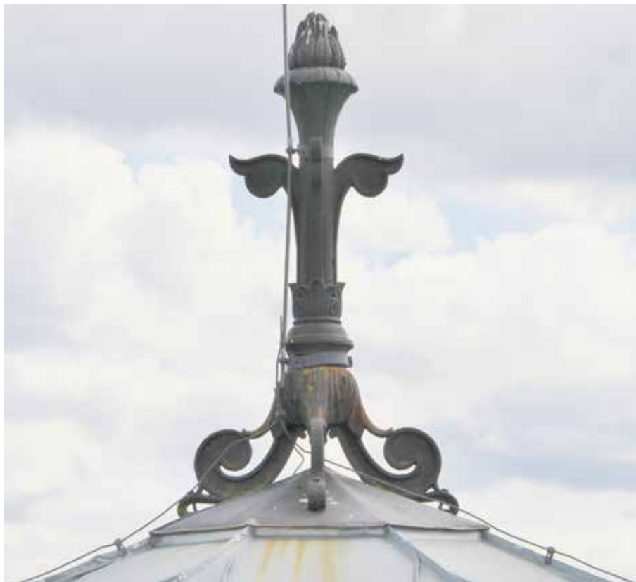
Figur 3.13. En gjuten takspira rostar och läcker järnjoner på ett omålat förzinkat plåttak. Zinken missfärgas men korrosionshastigheten av zinken är förhållandevis låg eftersom det i det här fallet är fråga om förhållandet stor anodyta i kontakt med liten katodyta. Den gjutna spiran behöver rostskyddsmålas.
