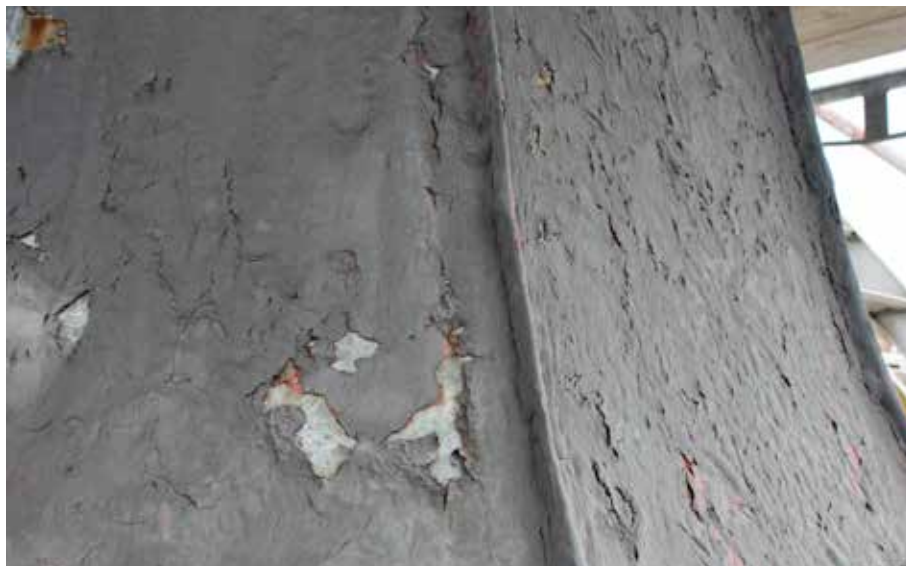
Figur 4.21. Tornet på Slottsvillan i Huskvarna. Plåttaket var behandlat med asfaltmassa, som förorsakat läckage p.g.a. korrosionsskador under skikten. Taket lades om.
