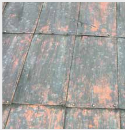
Äldre svartplåt med eroderad linoljefärg på blymönjegrund.
