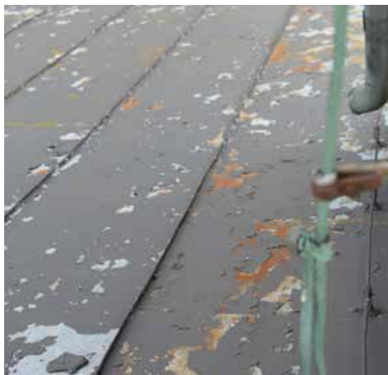
Figur 5.6. Stuprör och åskledare av koppar har gett markanta korrosionsangrepp i en förzinkad plåt, där kopparjoner frigörs genom avrinning närmast ett torn. Här är det lämpligt att stryka några extra färgskikt för att bygga total färgskiktjocklek med bättre elektrokemisk isoleringsförmåga. Södra Solberga kyrka i Växjö stift.
