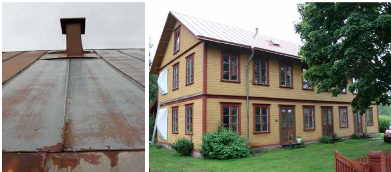
Figur 6.21 och 6.22. Byggnadsminnet Idelunds Möbelsnickeri i Aneby kommun, hade ett plastisolbelagt plåttak. Vid ommålningen 2013 sandblästrades taket och rostfläckarna slipades bort efter blästringen. Taket målades därefter med grundfärg av zinkfosfaterad alkydoljefärg samt mellan- och färdigströks med fet linoljealkyd.
