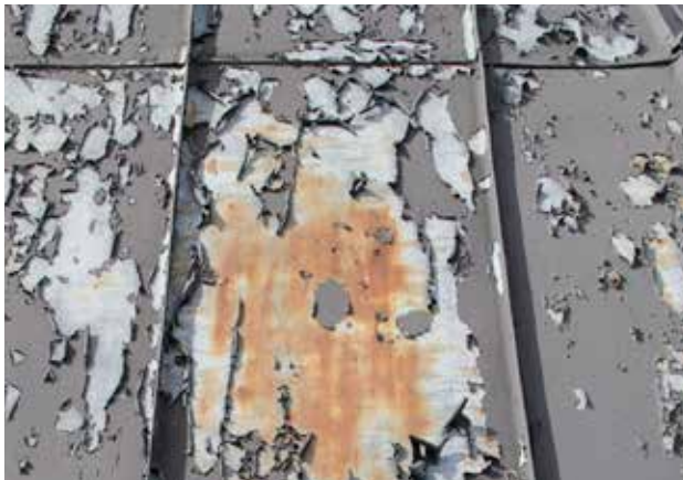
Figur 3.10. Ett ståltag passiveras inte naturligt genom täta reaktionsprodukter när det utsätts för atmosfärens inverkan, som takplåt av koppar, zink, bly eller aluzinkmetallisering gör. När stålplåten inte längre skyddas genom katodiska skydd och/eller rostskyddsmålning kommer den att rosta.
