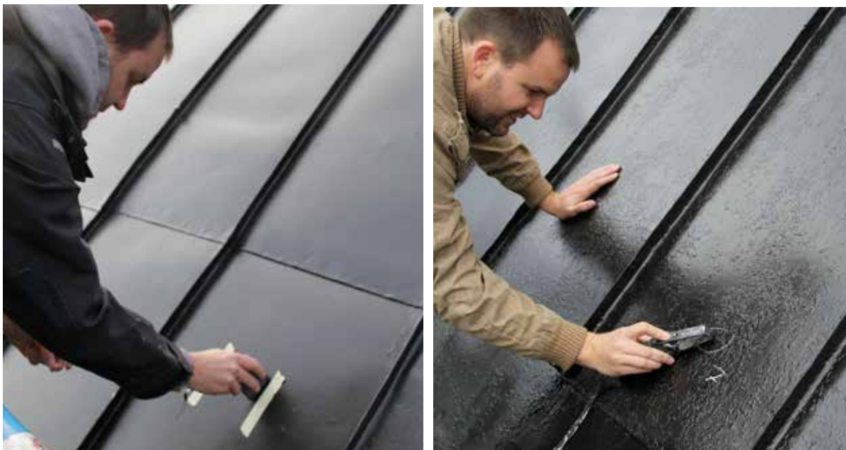
Figur 4.41. och 4.42. Magnetinduktiv mätning av tak med två olika mätmetoder. Mätställena markeras med tejp eller tavelkrita, fotograferas och förs in på ritning och utgör tillsammans med mätprotokoll en del av dokumentationen. På varje mätställe är det lätt att få mätvärden på medeltjocklek, varians och standardavvikelse. Det finns också utrustningar där mätvärdena överförs till mobiltelefon eller platta med bluetooth. Mätning på Habo kyrkas tak 2015 av Johannes Magnusson i Hjo.
