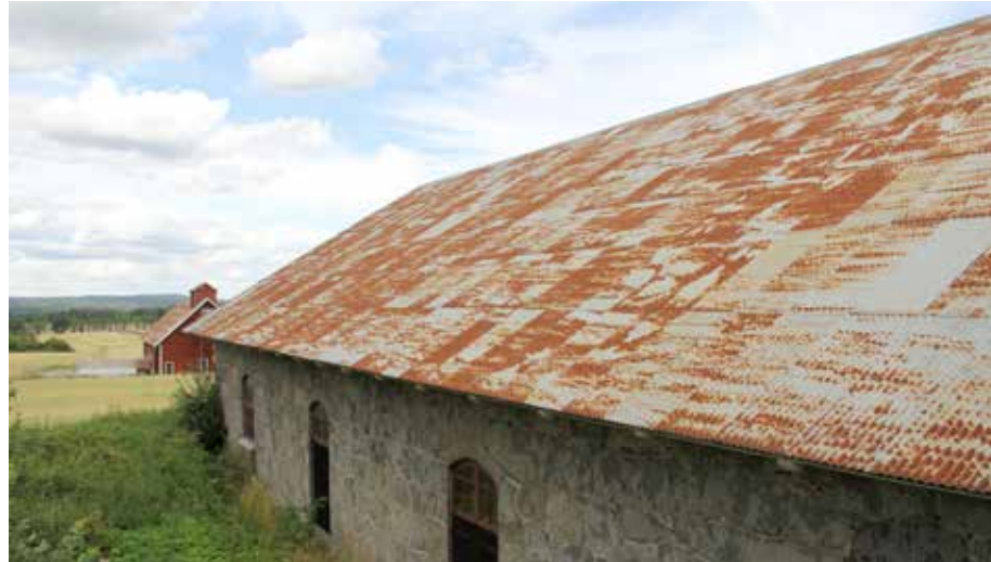
Figur 3.8. Stenmagasinet vid Björnebergs gård är ett exempel på en skyddad byggnad med ett rostigt korrugerat plåttak. Björnebergs gård är ett byggnadsminne utanför Jönköping.
