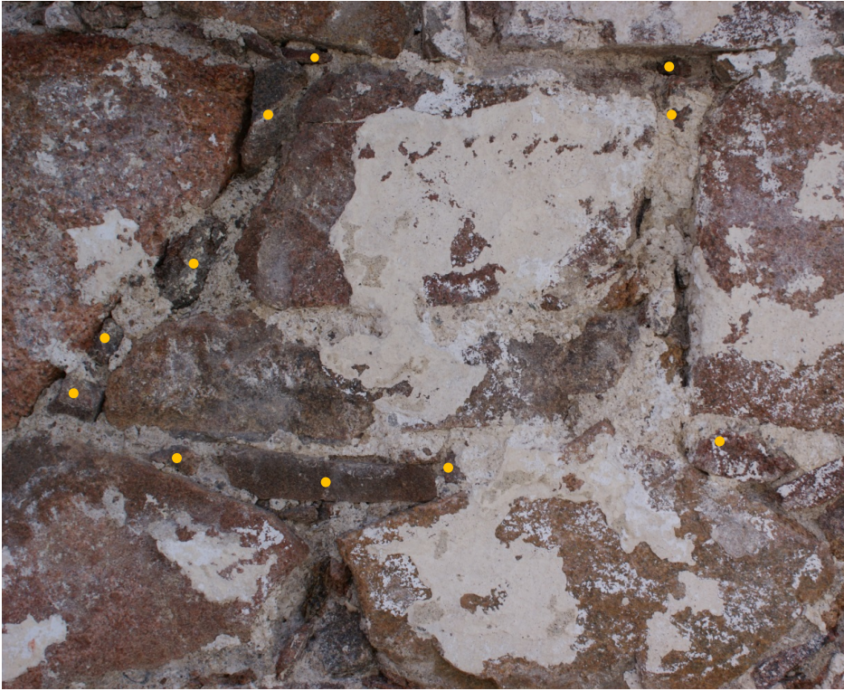
Figur 7. Murverket och rester av en tunn puts på Svenneby gamla kyrkas långhus. Fogen runt de större stenarna i murverket är omsorgsfullt skolad eller pinnad med mindre sten. Med orange punkt är några exempel på skolsten markerad i bilden. Skolstenen är intryckt i fogen något innanför stenens yttre kant. Sättet att skola minskar fogbredden, låser stenen i sitt läge och minskar bruksåtgången.
