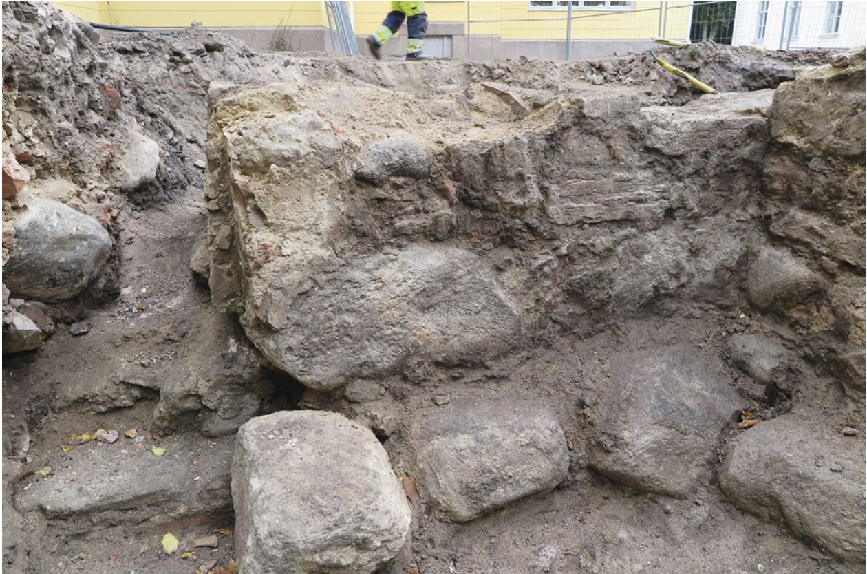
Figur 88. Den norra källarens östra mur 699. Till vänster i bild syns den sekundära dörröppningen 706.
