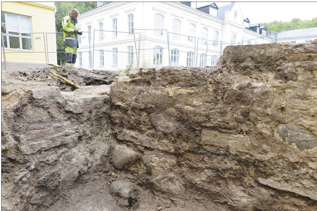
Figur 91. Innerväggen mellan den södra och norra källaren i byggnad F. Den norra sidan, 697, som ligger i stöt mot östmuren 648=699.
