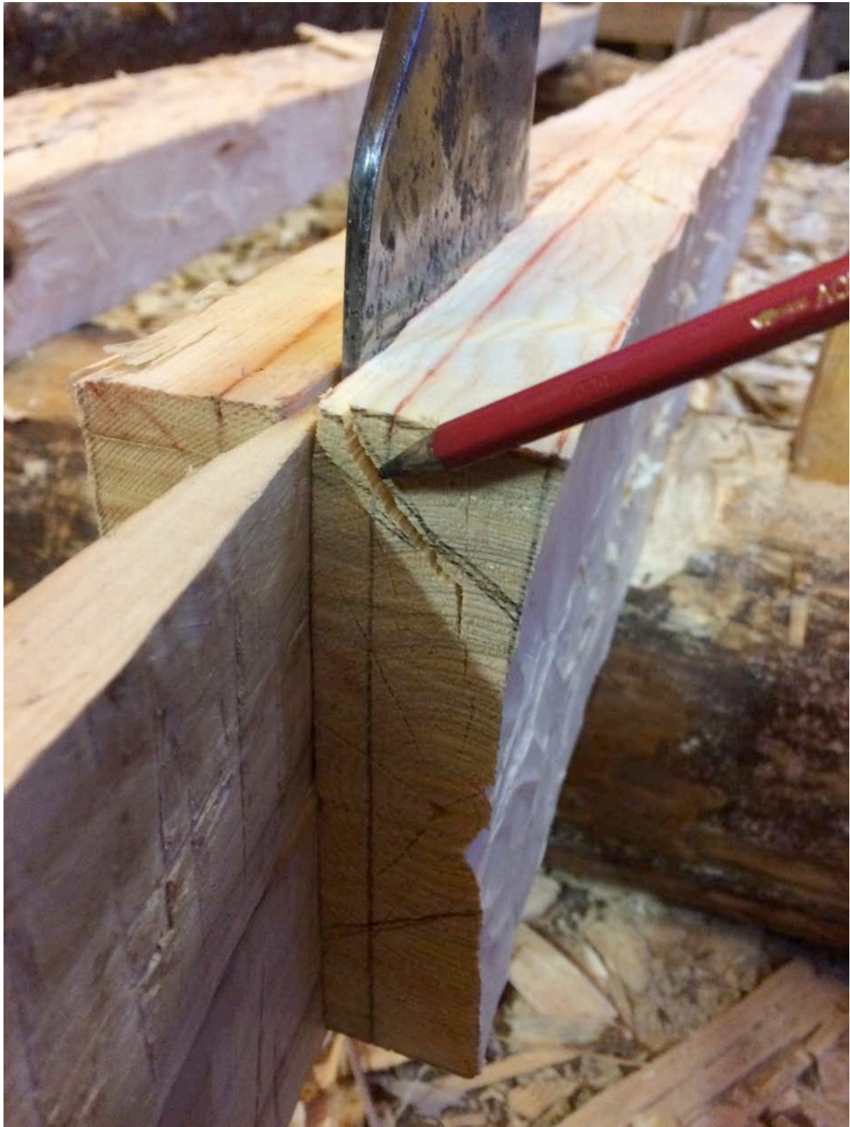
Fig. 31 Spårning detalj: Uppkomst av spricka i änden, också den en parallell spjälkning i vedlagren. Kilen stödjer upp och hindrar sprickan från att fortsätta.
