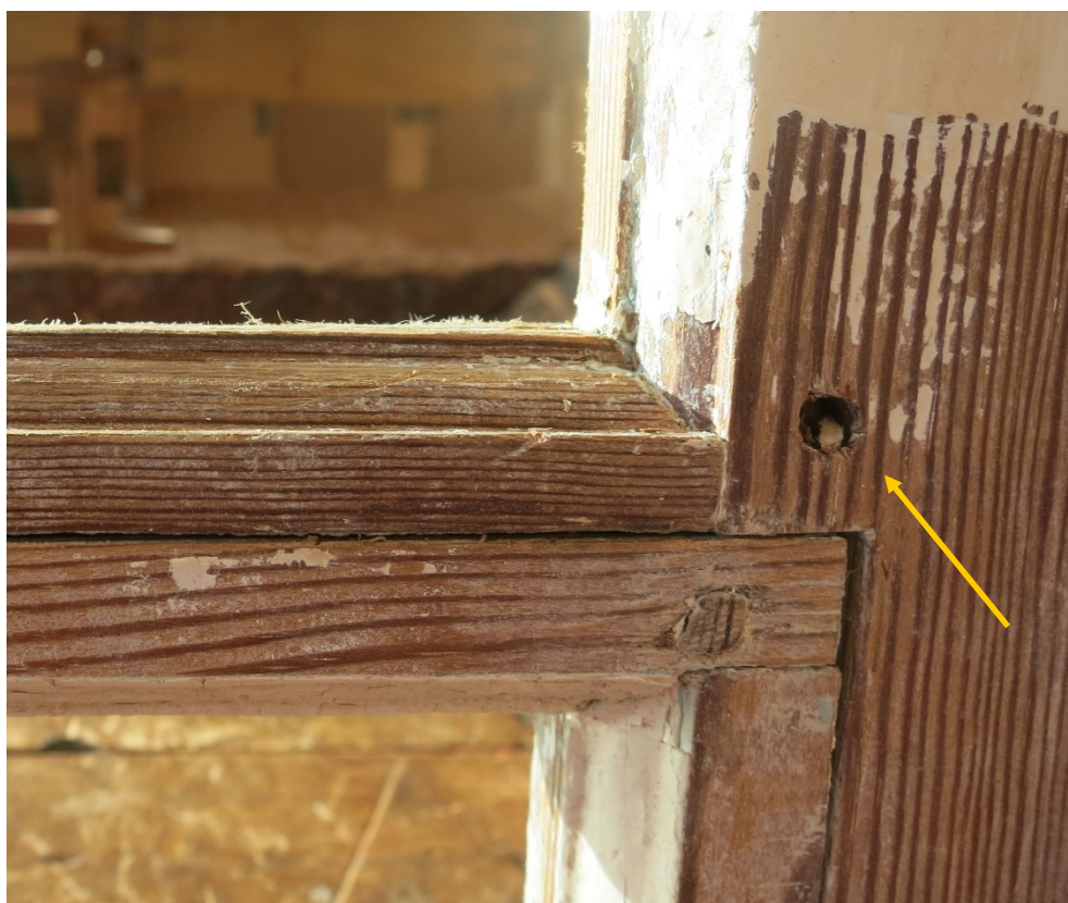
Figur 12. Bågens spröjs är pinnad ovanför och under lättrutan. Pilen visar att pinnen är centrerad på spröjsets totala bredd.
