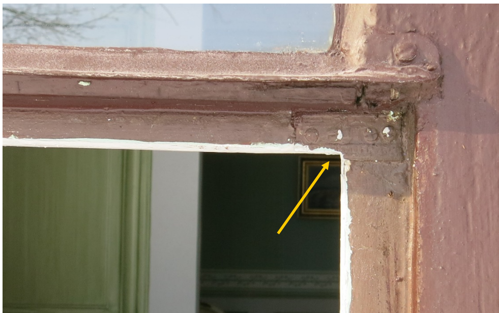
Figur 30. Bågens innerhörn är förstärkta med en bit plåt. (gul pil).
