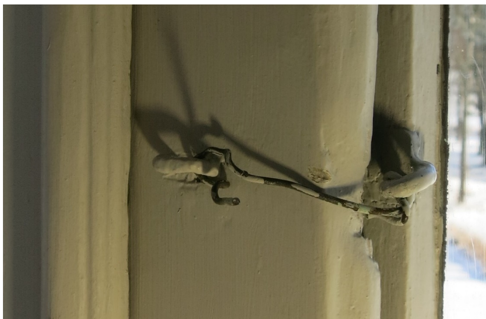
Figur 32. Lättrutan låses med två skruvöglor och en bit ståltråd.
