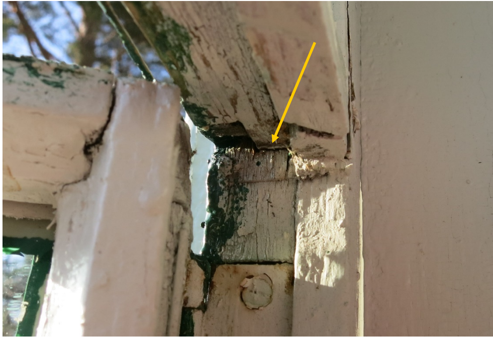
Figur 41. Bågens spröjsstappar har samma form som spröjsen (gul pil).
