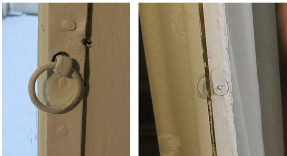
Figur 26. Vådringsrutan låses med ett enkelt lås.
