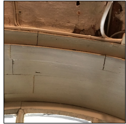
Bild 46 – Den inre falsen var av limmad modell, vilket syntes på skarvarna och glipan mellan lötningslagren.
