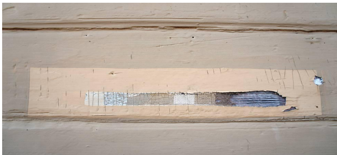
Figur 4. Färgtrappa på fasad med liggande panel. Foto: Victoria Korth.
