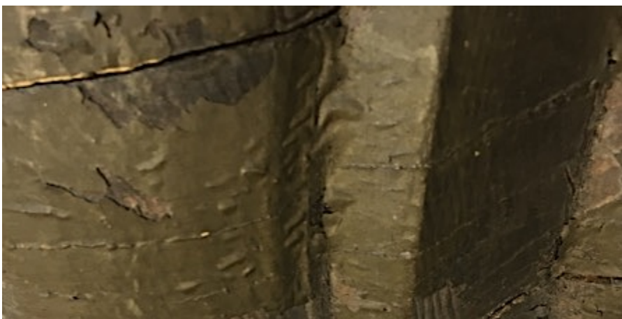
Figur 20. Skaftets gröna färgskikt med tydlig skiktseparation.
