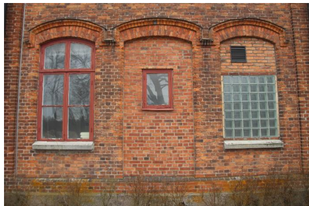
Fig. 18. Mot parken har den gamla entrédörren murats igen och en av fönsterbågarna har ersatts med betongglasblock. Fotograferat i april 2018.
