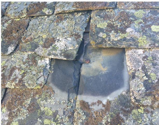
Figur 16. En skifferplatta saknas och här krävs en lagning för att hindra dagvatten från att leta sig in under skiffertäckningen. Bolstads kyrka. Foto: Takskifferprojektet i Karlstads stift.
