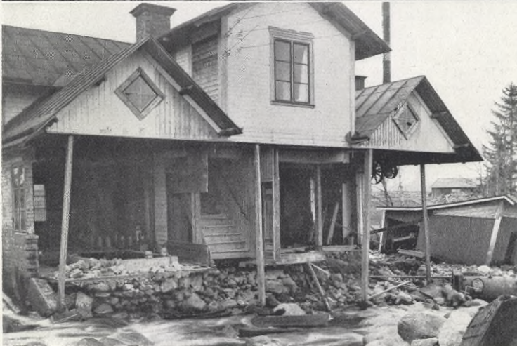
STRÖMSBORGS MEJERI I OCKELBO som illa skadats af öfversvämningen.
