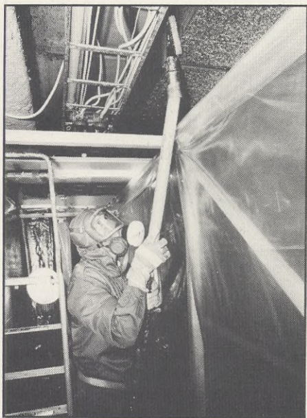
Det behövs bättre metoder för asbestsanering. Det man idag kan göra är i stort sett att skrapa och dammsuga. Foto: Björje Thuresson.
