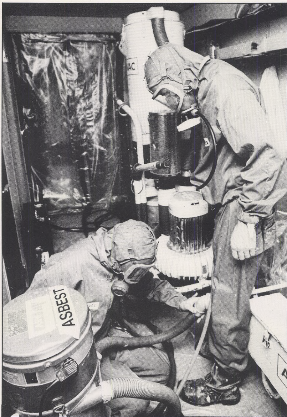
Vid rivnings- och reparationsarbete med asbest skall man använda tätslutande skyddskläder med huvudbonad och andningsskydd. Foto: Börje Thuresson.
