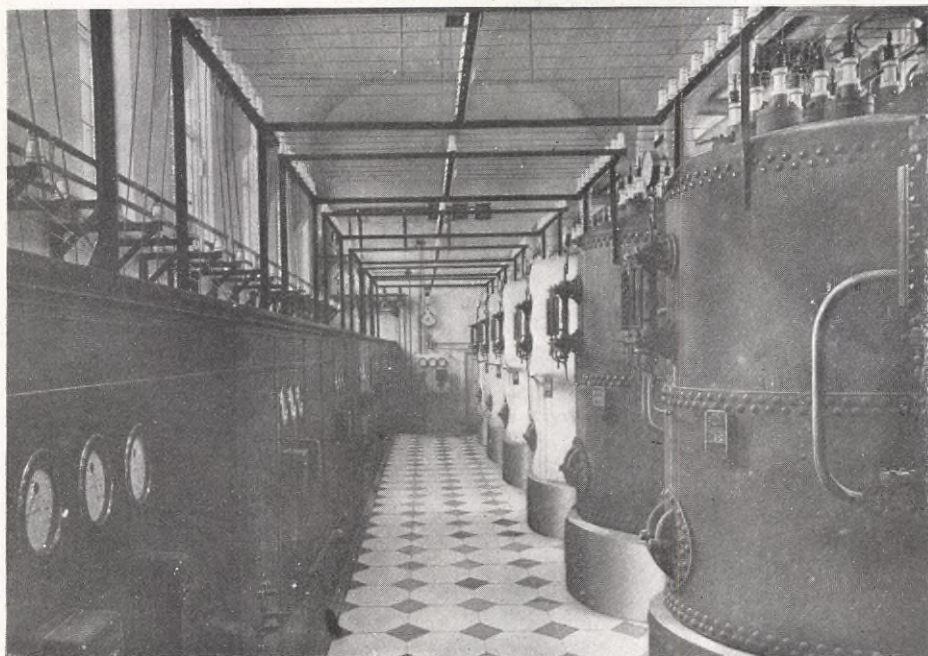
ELEKTRISK ÅNGPANNEANLÄGGNING VID WARGÖN. — Efter foto.
