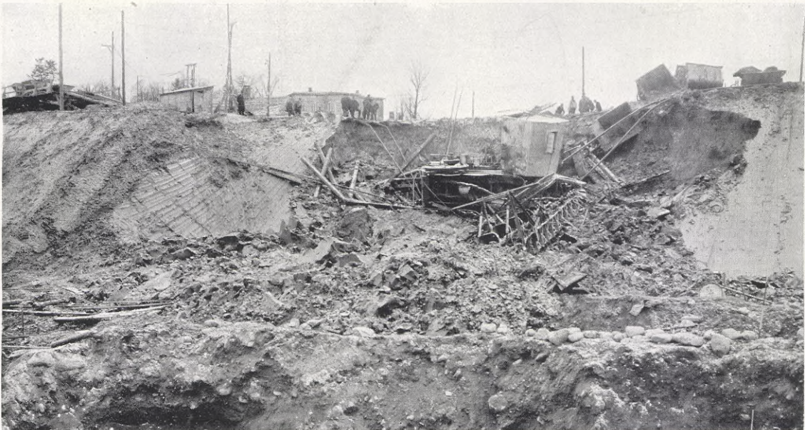
Foto Berns, Lilla Edet RASET VID KANALBYGGET VID LILLA EDET DEN 19 FEBR. Vy af olycksplatsen efter raset, som drog fem arbetare med sig, däraf två omkommo.
