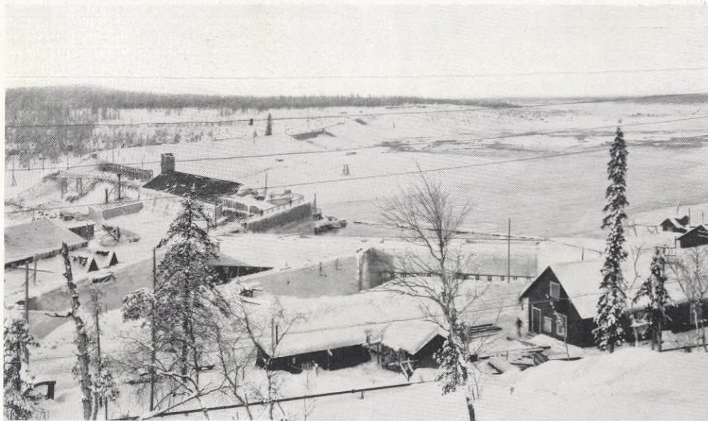
I PORJUS: Utsikt äfver intaget och stora regleringsdämnarna vid Porjus. I midten af älfven synes det stora varmhäuset i hvilket arbetet med betonggjutningen af sista delen af stora skibordet nu pågår.
