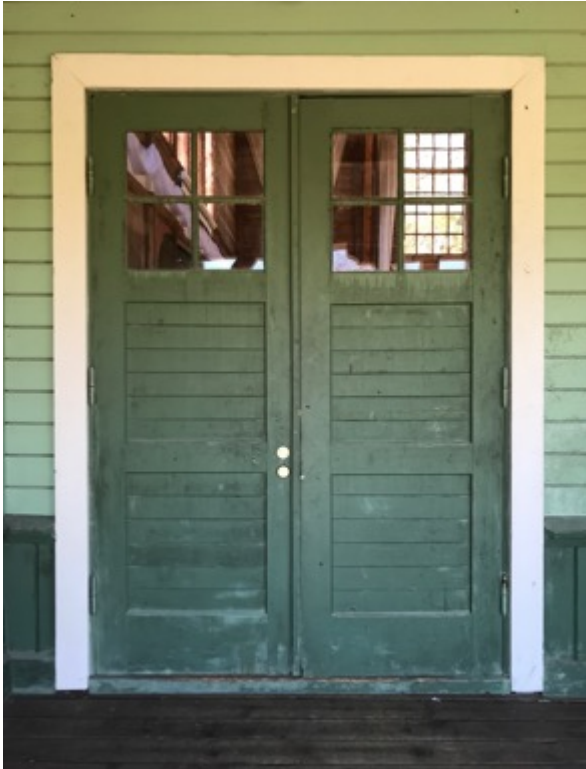
Fig 7. En av tre pardörrar in till Lekhuset på den östra långsidan. Rutorna var tidigare försedda med galler för att skydda glasen vid bollspel.
