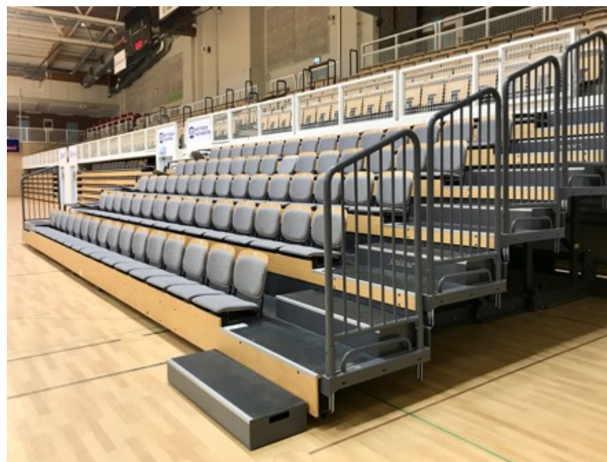
Fig 118. Utfälld teleskopläktare i sporthallen.
