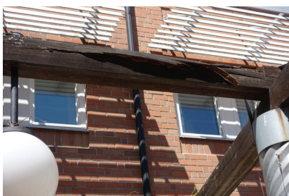
Bild 74. Skador i träkonstruktionen. Foto: författaren.
