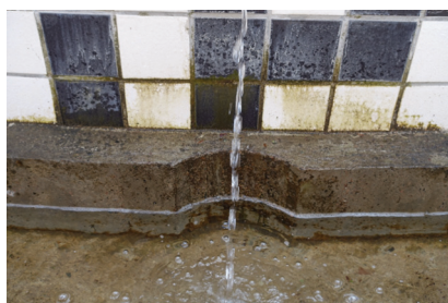
Bild 75. Algpåväxt, sprickor och avslag. Foto: författaren.
