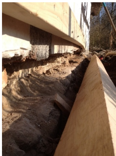
Figur 24 Nytt fotträ på väg att passas in. Man kan ana att lite av grunden har grävts bort för att lättare komma åt fotträet, här har dock befintliga stolptappar sågats av. Foto Jens Ingvad
