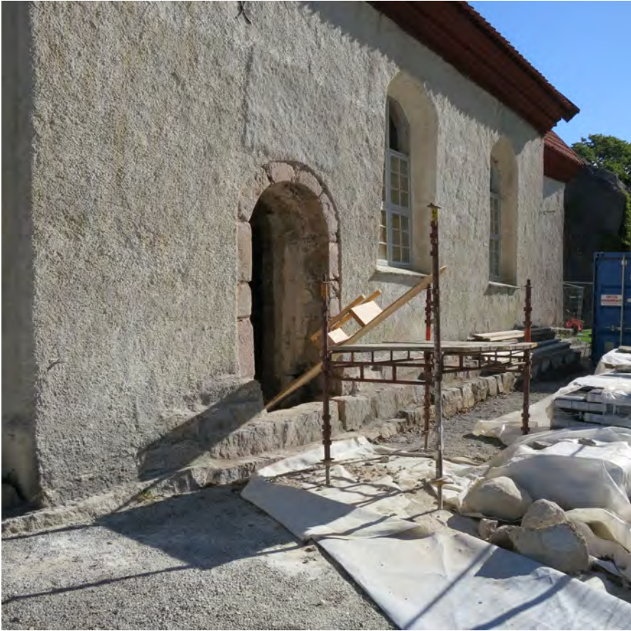
Figur 3. Den romanska portalen i Svenneby gamla kyrkas sydvägg tas fram bakom putsen. Arbetet genomfördes i samband med att kyrkan stabiliserades och restaurerades 2014-2016. Foto: Författaren.
