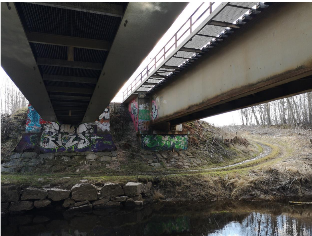
Figur 23 Brofundamenten på den södra stranden pryds av likartad graffiti som på norrsidan. En traktorstig, som löper från en närliggande enskild väg, leder här under bron. Foto: Willie Nordström.
