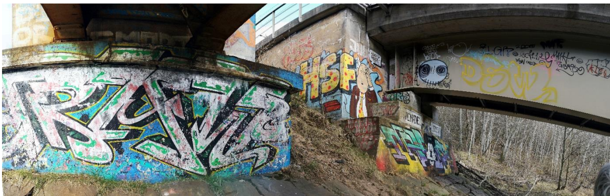
Figur 21 Panoramafotografi, taget från väst mot öst, visar de två norra brofundamentet. Motiven varierar i storlek och form men är i samtliga fall målade. Foto: Willie Nordström.
