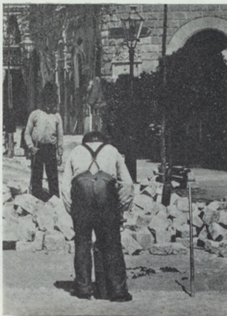
Sätta gatsten var ett "stort yrke", ett jobb av klassiskt märke i våra städer vid sekelskiftet.
