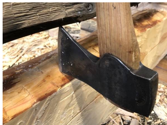
Figur 65. Att markera ut något i lod utan verktyg ställer höga krav på hantverkarens ögonmått. På bilden gjordes försök att loda måttet med yxans egg. Jag gjorde även försök att syfta från en punkt i den övre stocken till den undre genom att loda ner blicken.
