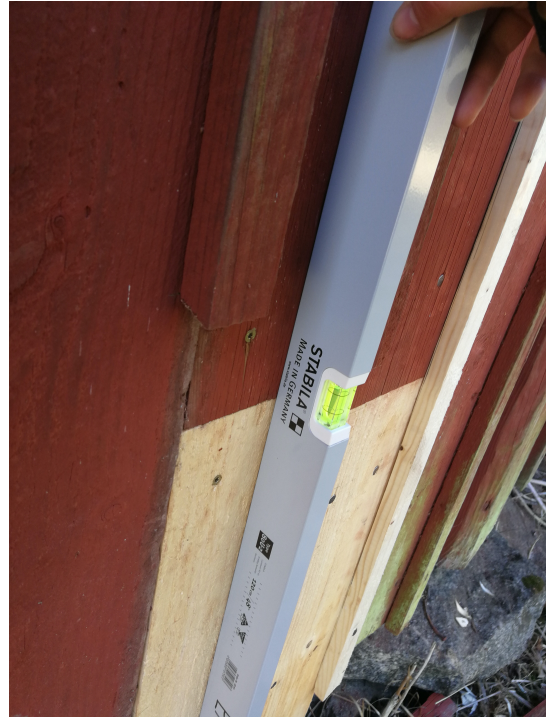
Figur 23. Egen metod. Vattenpass används för att se om skarven gjort panelen konkav eller konvex.
